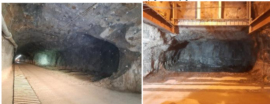
Creusement du lieu de contournement au concasseur et celui de dépassement des engins dans la liaison niveau 1150 m
