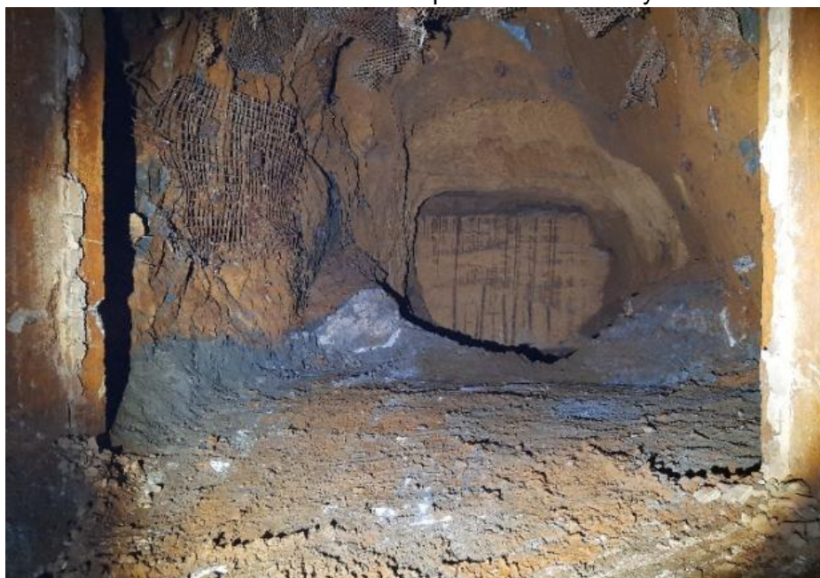
Figure 3. Vue du déversoir à minerais au Puits 21 parfaitement nettoyé au Niveau 1115 m.
